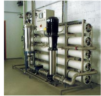
20 m 3 /h teljesítményű fordított ozmózis berendezés
